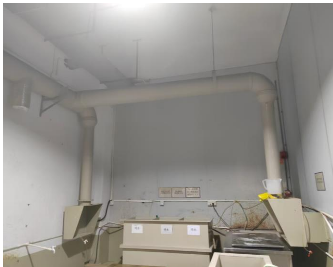
1 楼清洗线现状（手动线）
