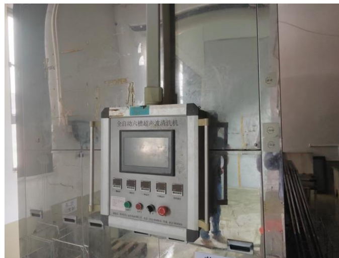
1 楼清洗线现状（自动线）
